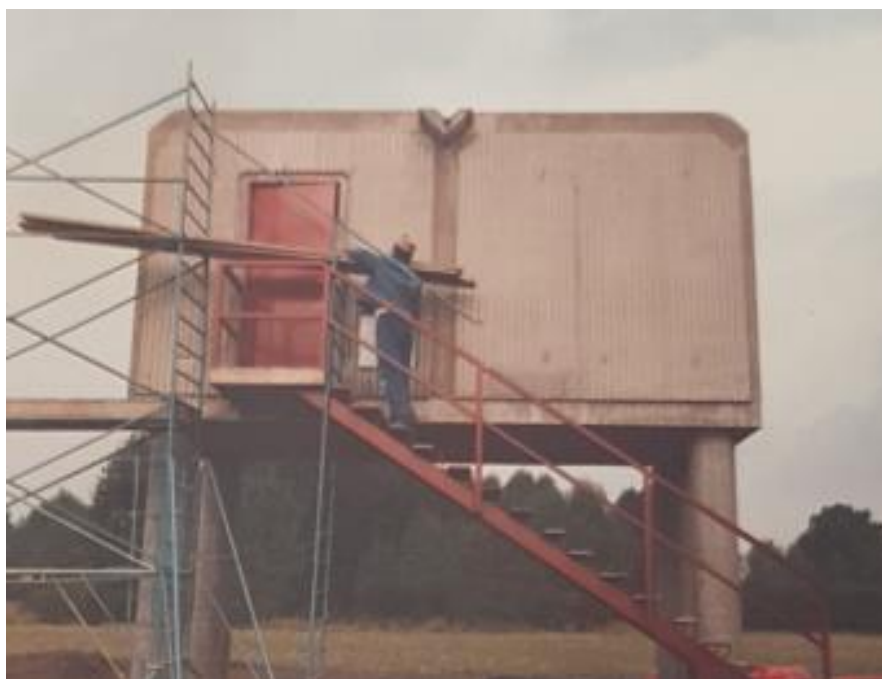
Figure 120 - Automatisation de la station existante d'Uckange. Début des années 1980, dans le cadre du projet SARDAC. (Source : Archives DREAL Grand Est)
